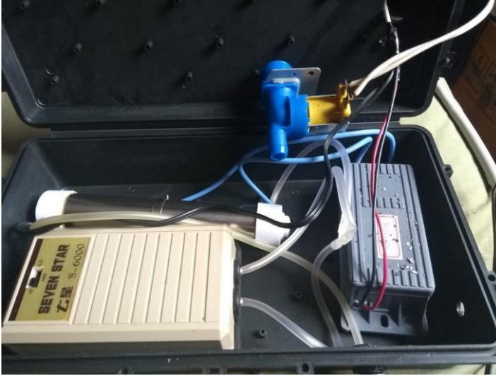
Figura 12: Montagem do sistema no compartimento.
