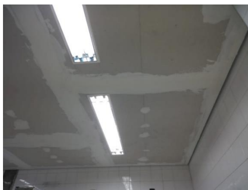
Figura 50: “Forro em placas de gesso acartonado (Drywall)”
