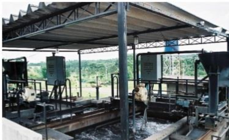
Figura 26 - Caixa de areia
