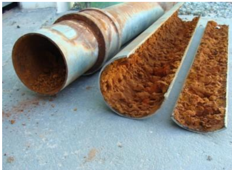
Figura 06 - Tubulação com incrustações
