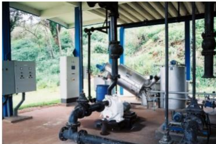
Figura 31 - Adensador de lodo
