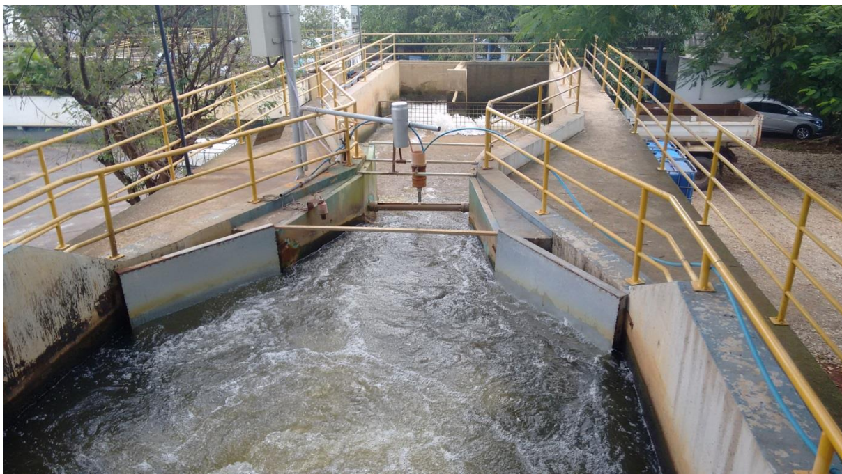
Figura 10 - Calha de Parshall
