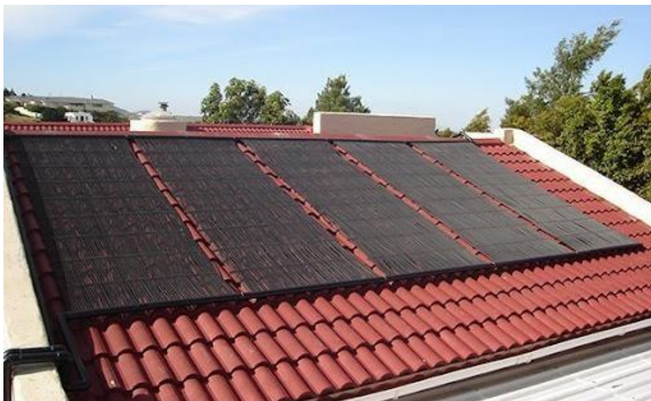
Figura 14 - Residência com coletor solar Fonte: Cotanet, 2018
