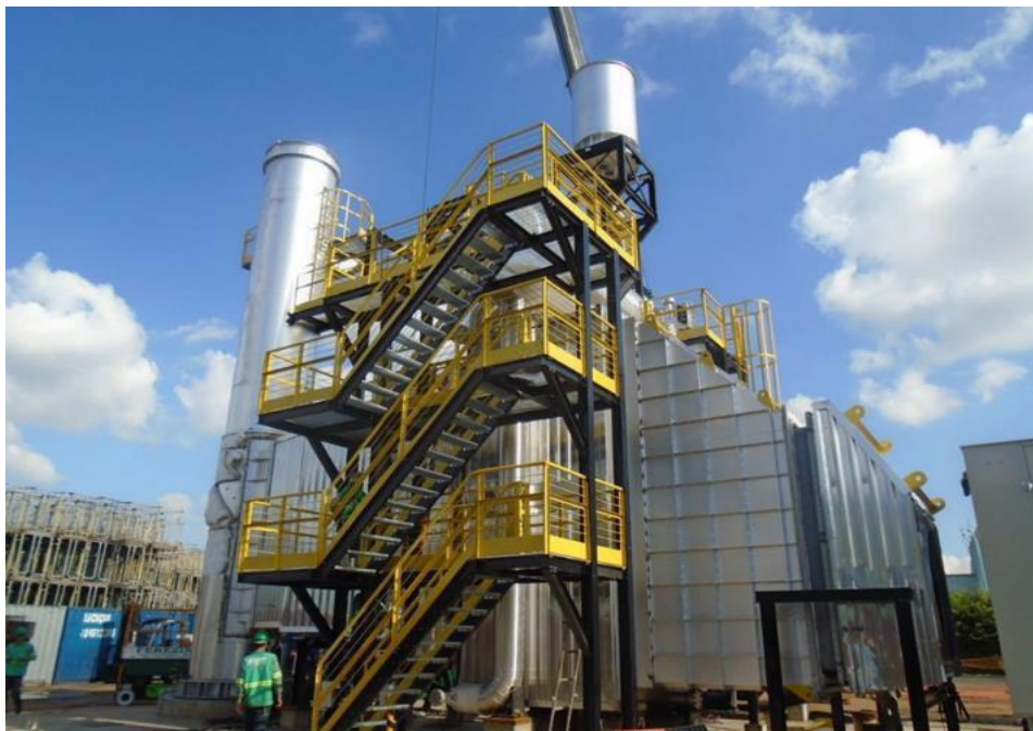
Figura 14 - Geração de vapor (Caldeiras)
