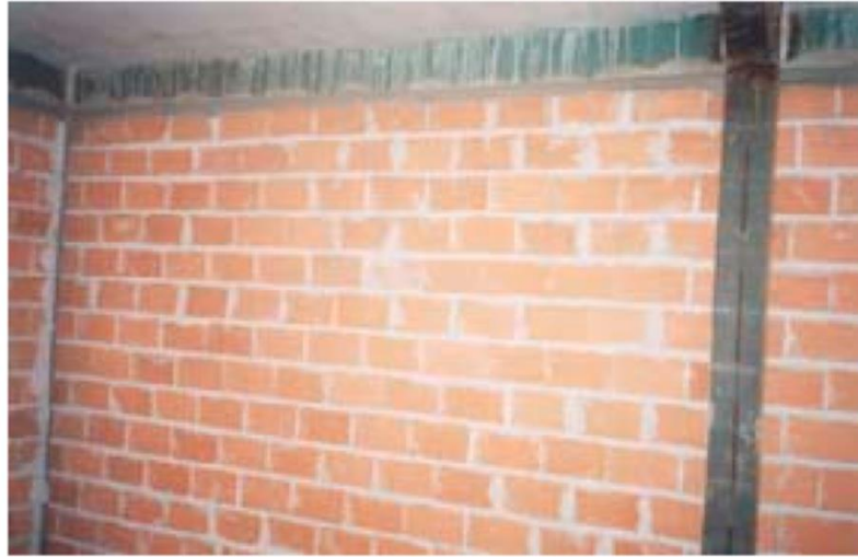
Figura 10: Detalhe da amarração entre o pilar e a viga, sendo apresentado como ficará disposta a parede da residência depois da amarração da viga e do pilar.
