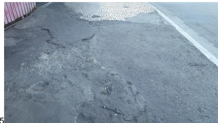
Figura 14: Buracos e desníveis presentes no Trecho 2: Rua Boipeva.
