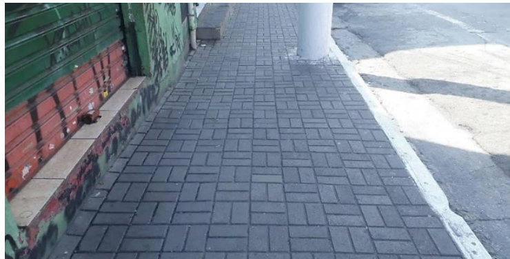
Figura 23: Buracos e desníveis presentes no Trecho 5: Rua Dr. Campos Moura.
