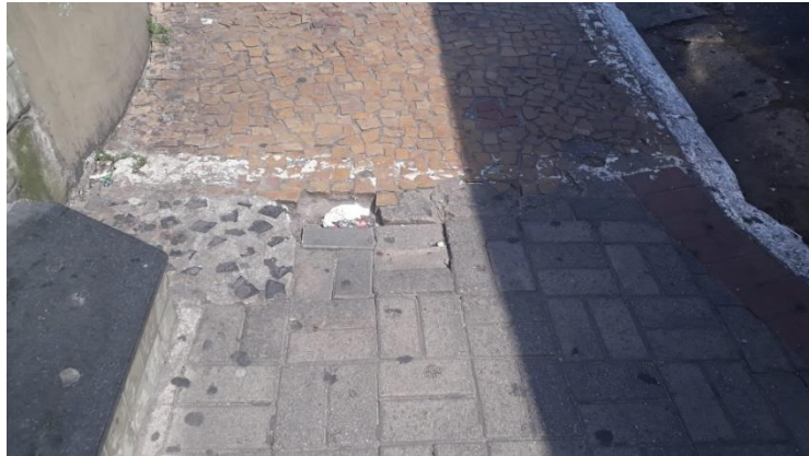
Figura 15: Buracos e desníveis presentes no Trecho 3: Rua Dr. Campos Moura.
