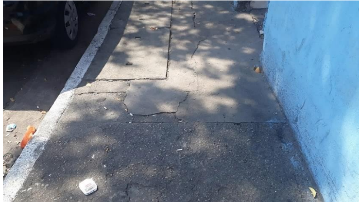
Figura 13: Buracos e desníveis presentes no Trecho 1: Rua Boipeva.
