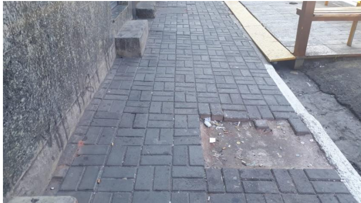
Figura 17: Buracos e desníveis presentes no Trecho 5: Rua Dr. Campos Moura.
