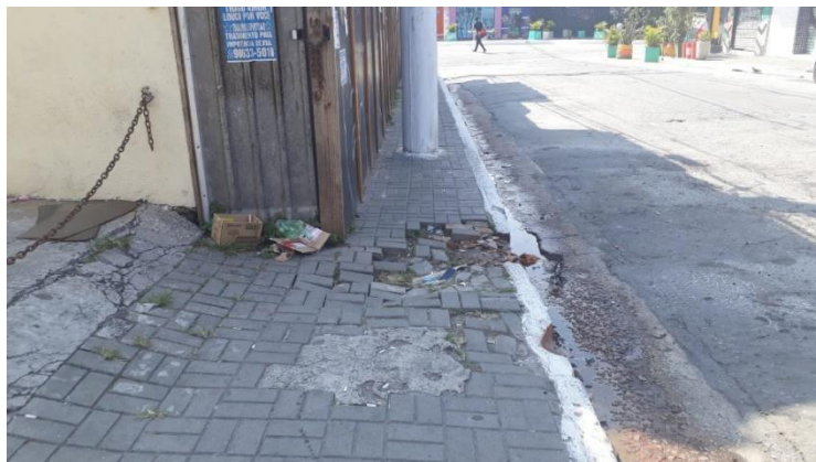
Figura 16: Buracos e desníveis presentes no Trecho 4: Rua Dr. Campos Moura.
