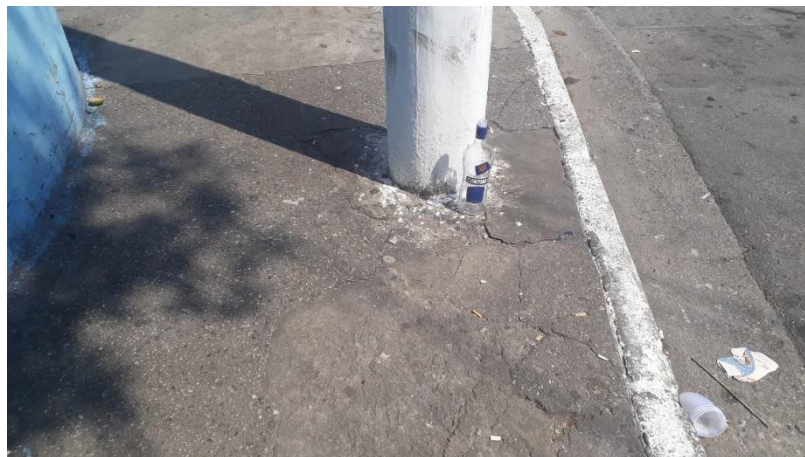
Figura 42: Detrito presente no Trecho 1: Rua Boipeva
