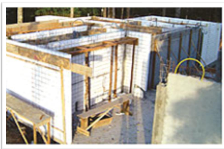
Figura 3 - Geralmente as obras com EPS empregam os mesmos materiais da construção civil tradicional.
