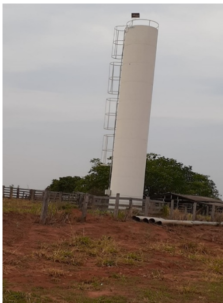
Figura 56: Poço artesiano e caixa d'água de abastecimento Fonte: Bazi, 2021
