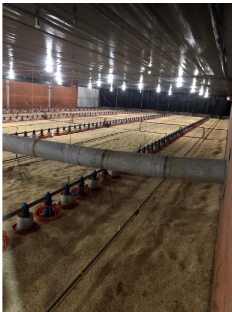
Figura 31: tubos ligados ao forno instalados na granja Fonte: Ferracini, 2021
