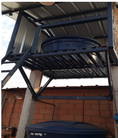
Figura 30: Caixa d'água que leva água para os bebedouros instalados Fonte: Ferracini, 2021
