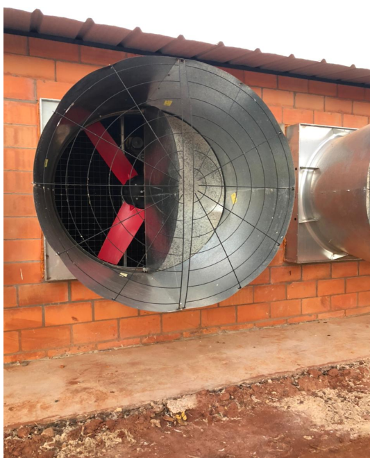
Figura 39: Exaustores ligados Fonte: Bazi, 2021
