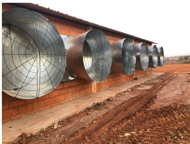
Figura 38: Exaustores desligados Fonte: Bazi, 2021
