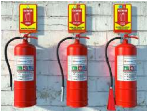
Figura 8 – Extintor de incêndio classe A e C
