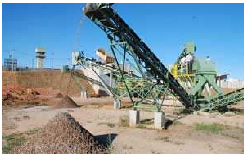
Figura 9 - URE Hortolândia (Usina de Reciclagem de Entulhos)
