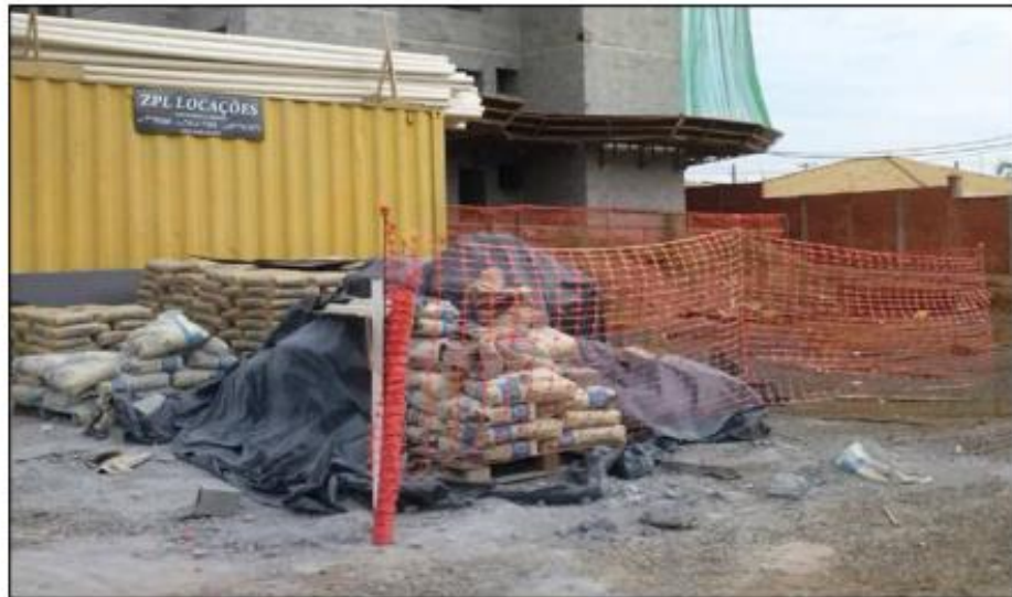
Figura 2 – Guarda de Ensacados (cimento, cal e argamassa)
