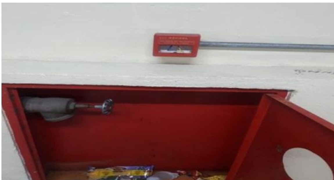
Figura Nº1 - Casa do hidrante sendo usado como lixeira
