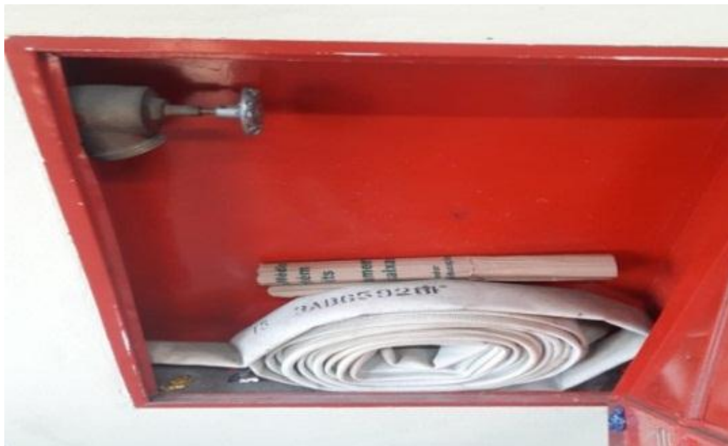
Figura Nº2 - Faltando o esguicho e o adaptador da mangueira
