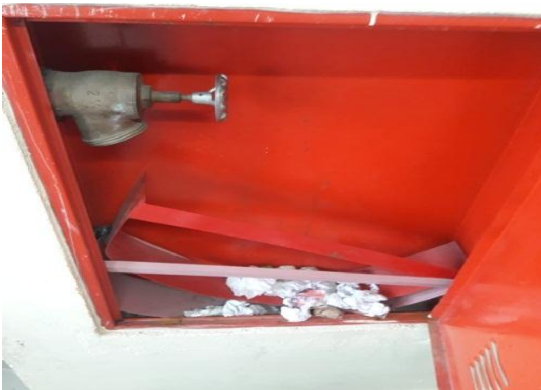
Figura Nº 4 - Hidrante faltando mangueira
