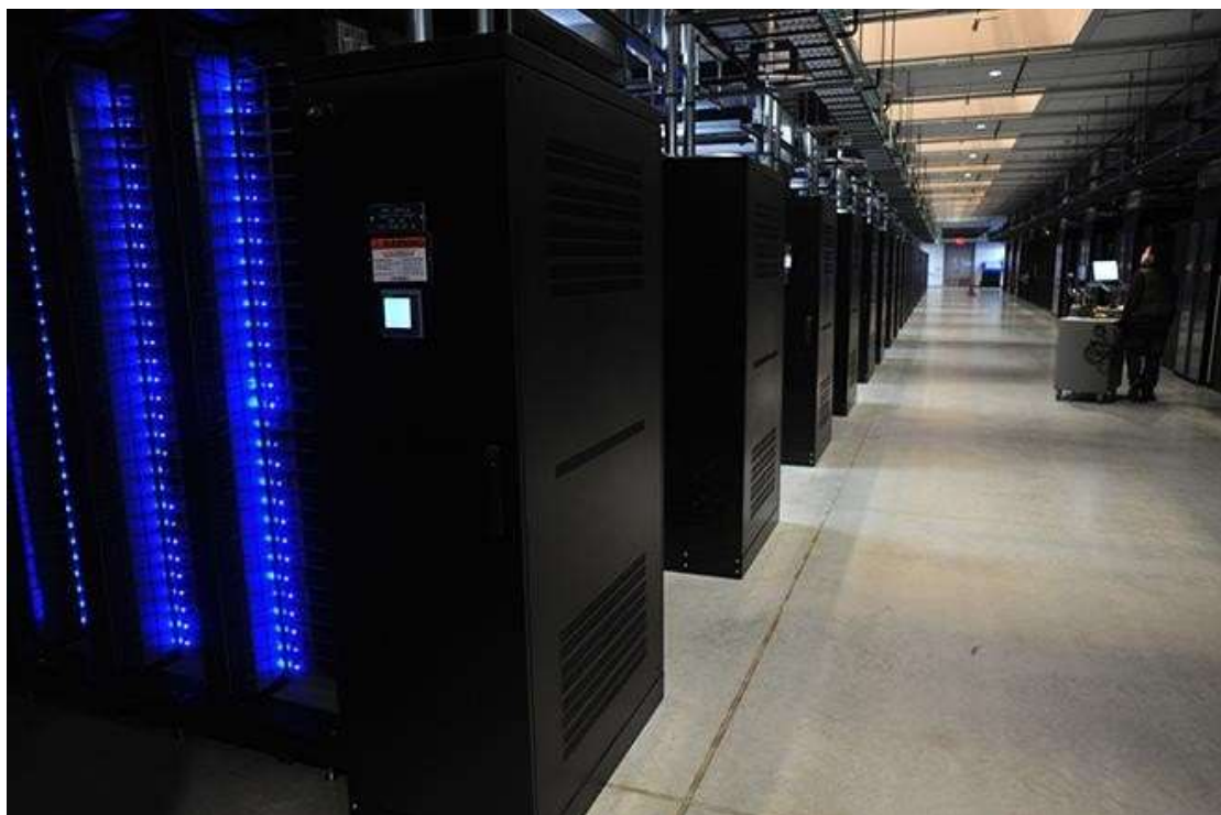
Figura 4 – Racks Freedom na sala de servidores do data center da Facebook
