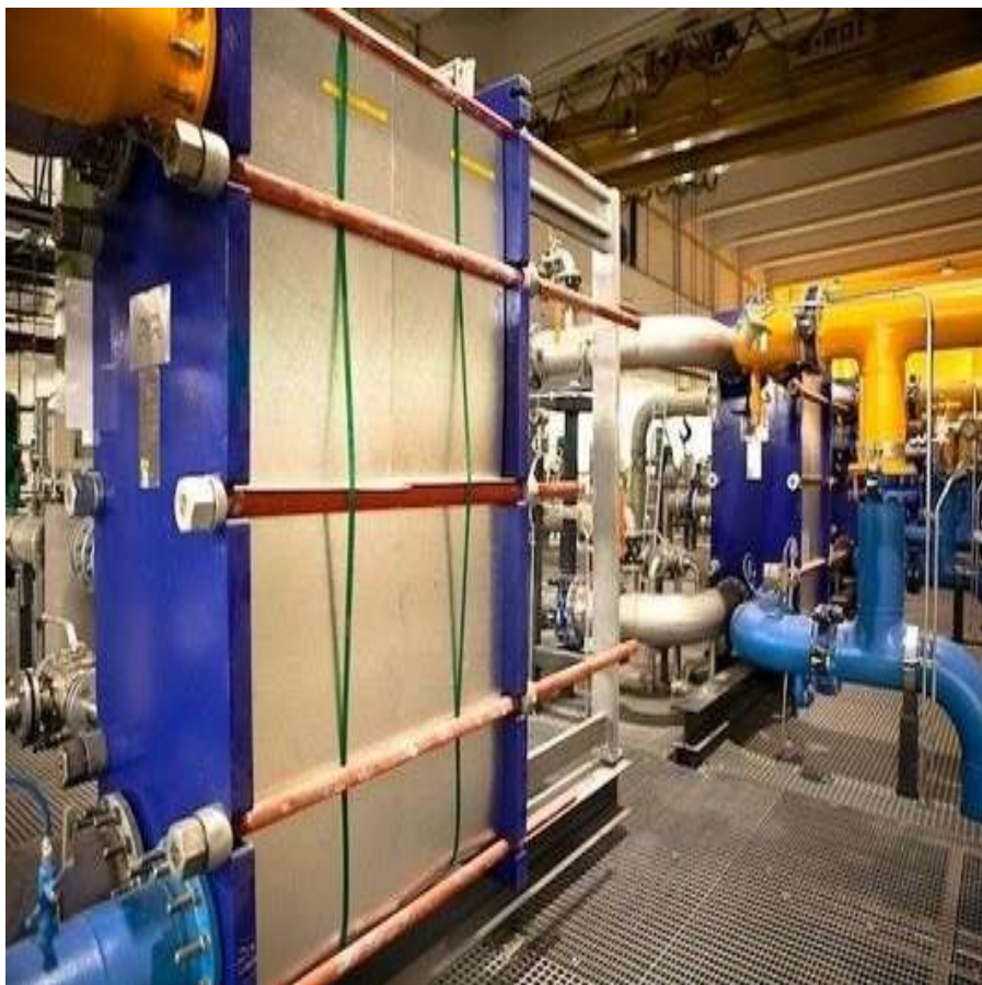
Figura 2 – Data Center da Google na Finlândia usa Sistema de Resfriamento Verde
