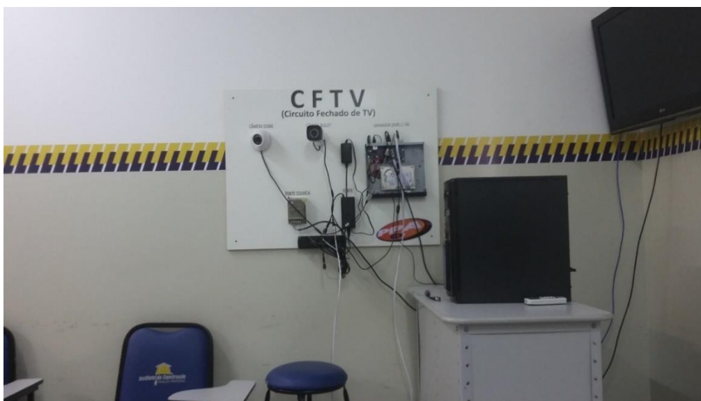
Figura 3: Sala de Cercas, Câmeras e Alarmes.
