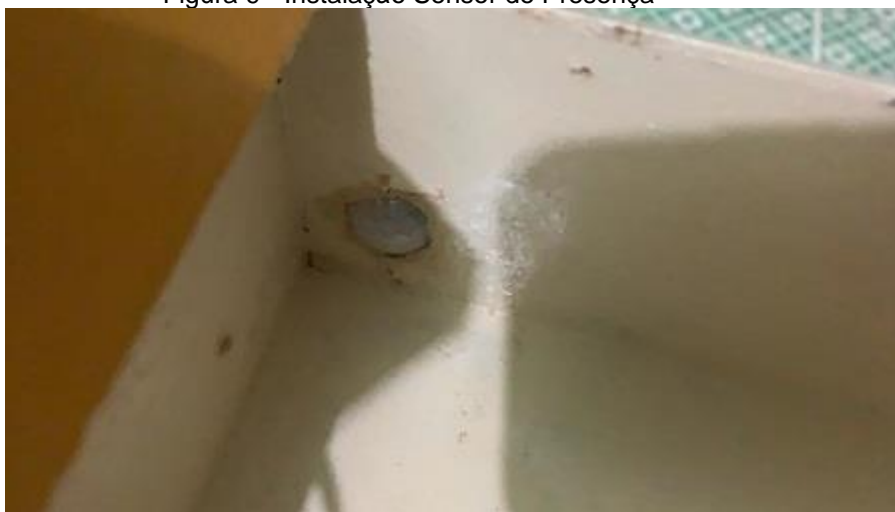
Figura 9 - Instalação Sensor de Presença
