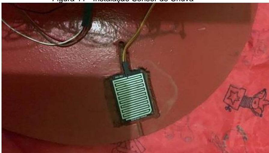
Figura 11 - Instalação Sensor de Chuva
