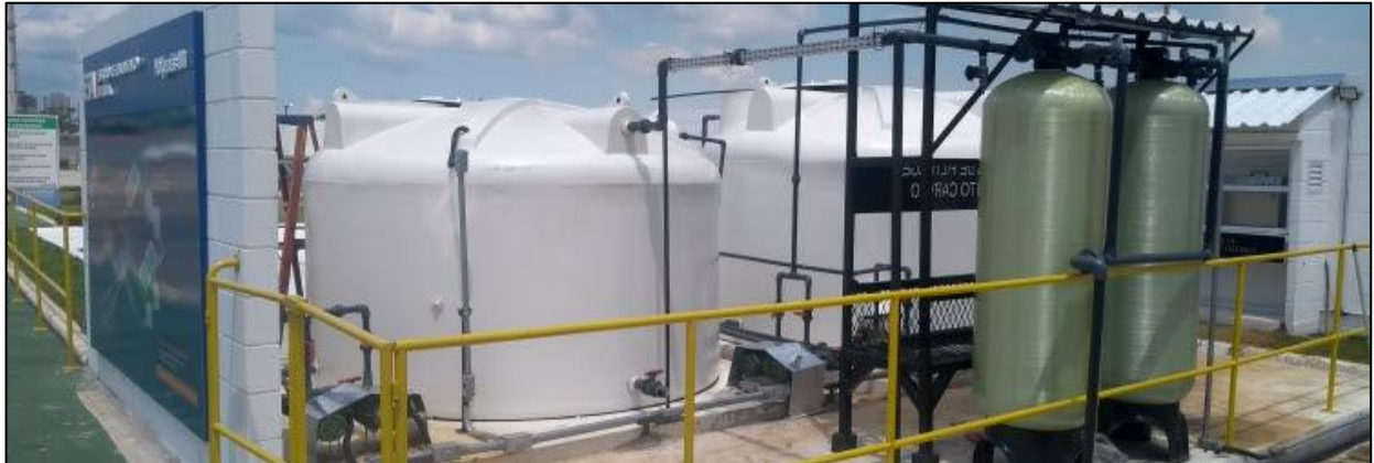
Figura 7 - Estação de Tratamento de Água (ETA) na planta de Mogi das Cruzes
