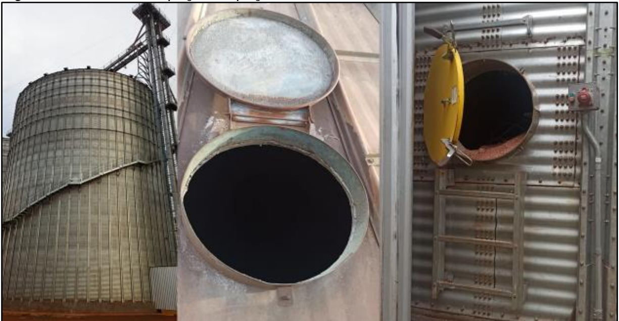
Figura 18 - Boca de inspeção-Espaço confinado
