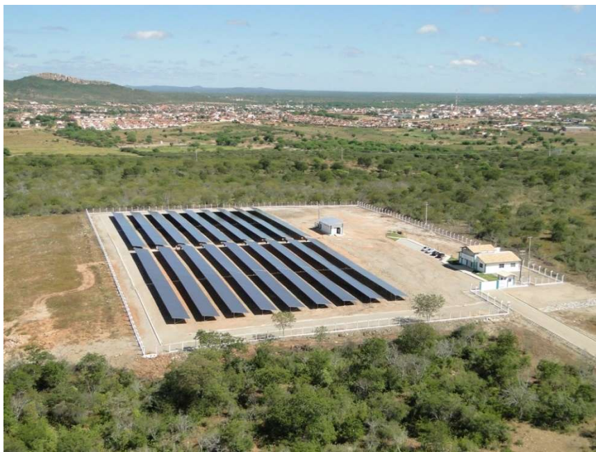
Figura 3 – Complexo da usina solar de Tauá no Ceará
