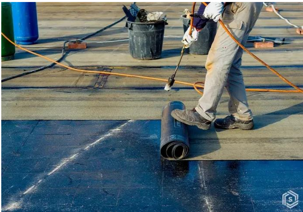
Figura 5 — Impermeabilização muito além das infiltrações
