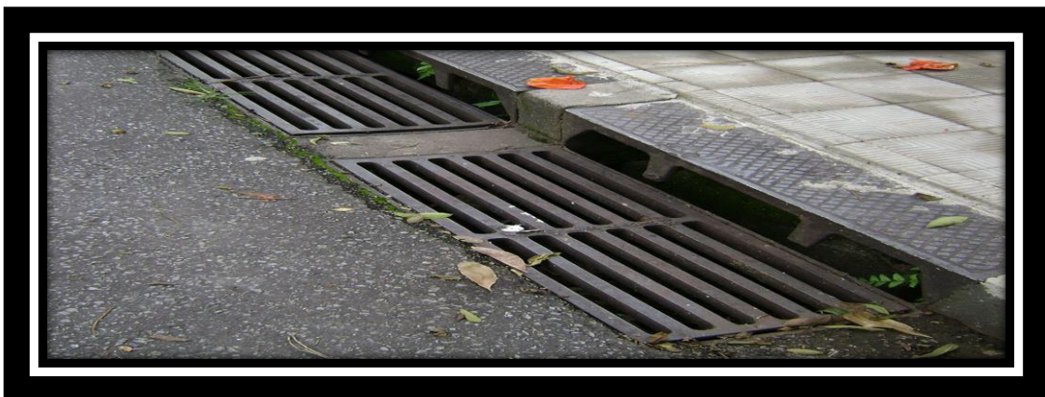
Figura 3- boca de lobo de grande vazão.
