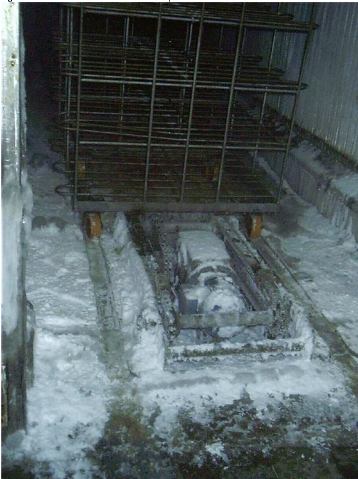
Figura 12 – O Problema do Acúmulo de Gelo pelas Paredes e Pisos dos Túneis
