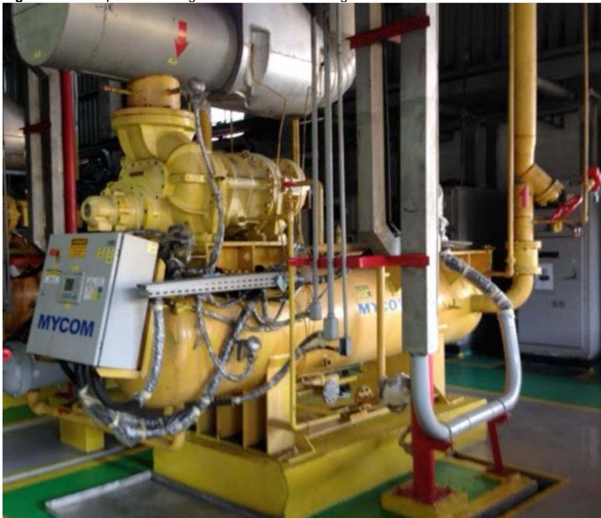
Figura 14 – Compressores de grande consumo de Energia Elétrica
