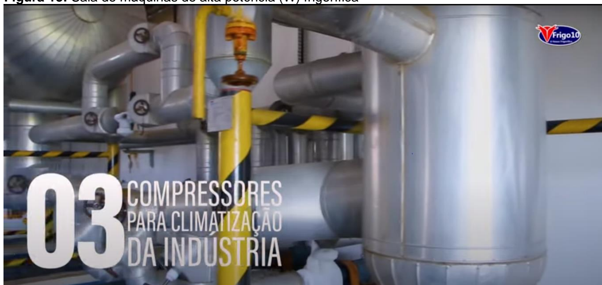
Figura 13: Sala de máquinas de alta potência (W) frigorífica
