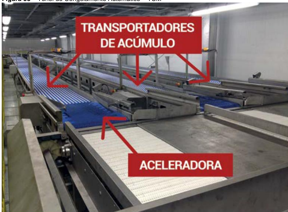
Figura 38 – Túnel de Congelamento Automático – TCM
