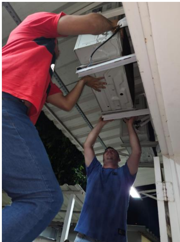
Figura 7 – Instalações das máquinas
