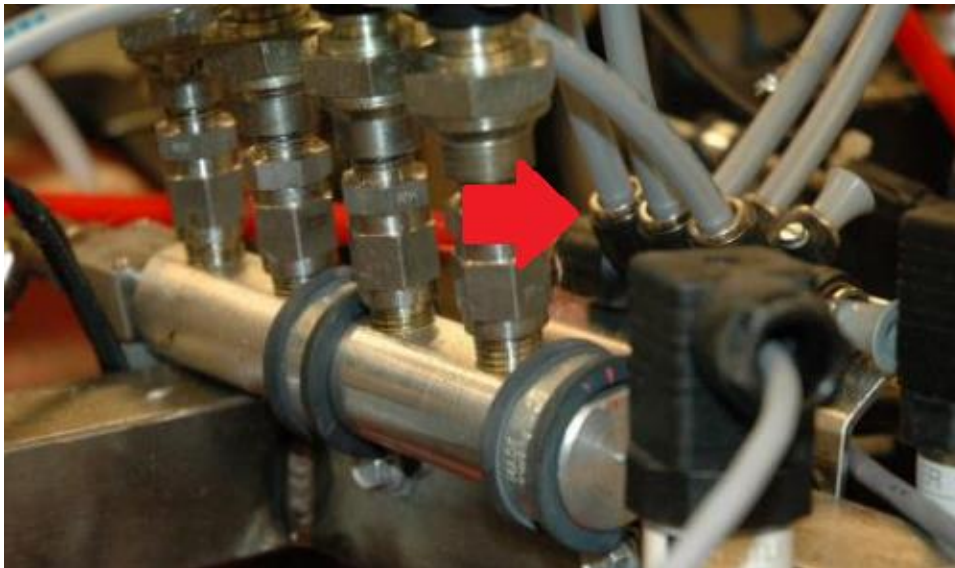
Figura 30 - Linha pneumática e hidráulica
