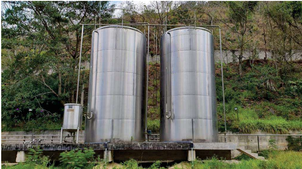
Figura 02 – Reservatórios de água mineral construídos em aço inoxidável.
