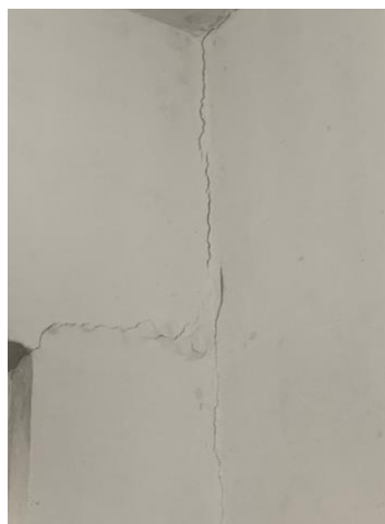
Figura 16 - Problemas da casa
