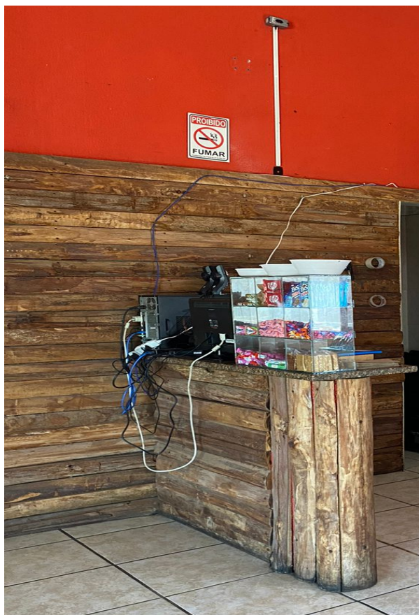
Figura 5 - Caixa com fios expostos
