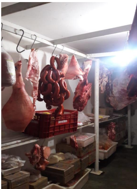
Figura 1. Câmara Frigorífica de Resfriamento
