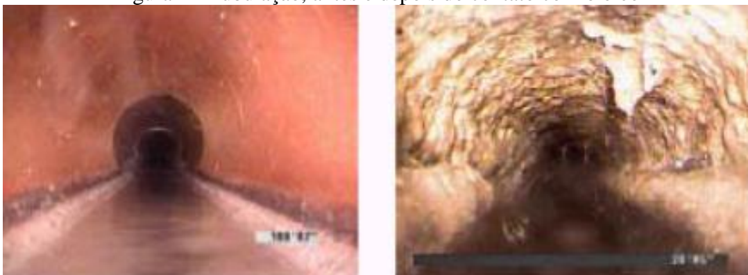
Figura 2 - Tubulação, antes e depois do contato com o óleo
