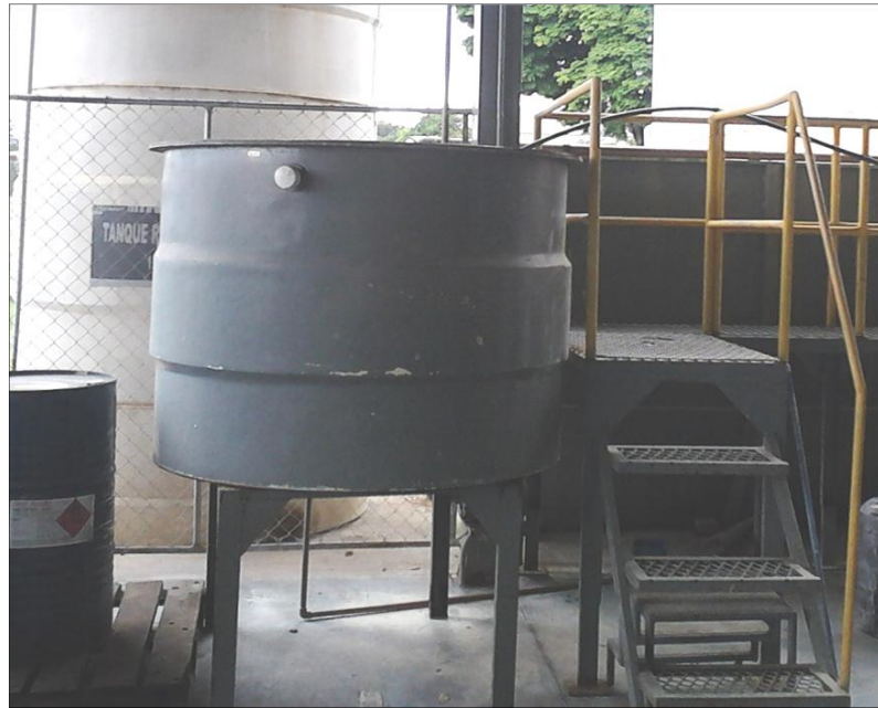
Figura 14 - Tanque de Correção
