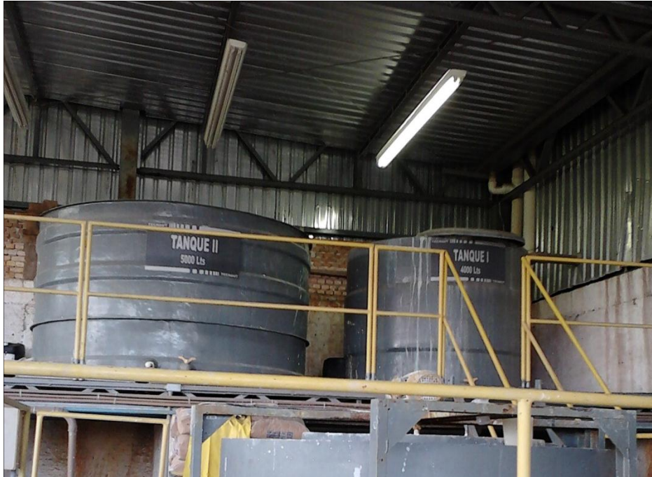
Figura 9 - Tanque de armazenamento
