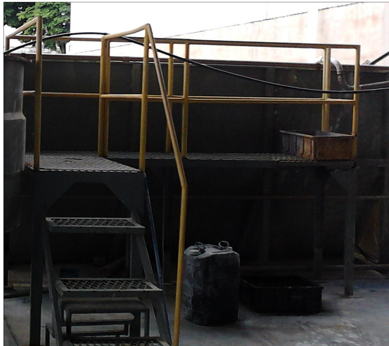
Figura 11 - Tanque de Decantação
