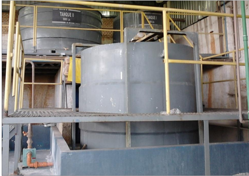
Figura 10 - Tanque de Tratamento
