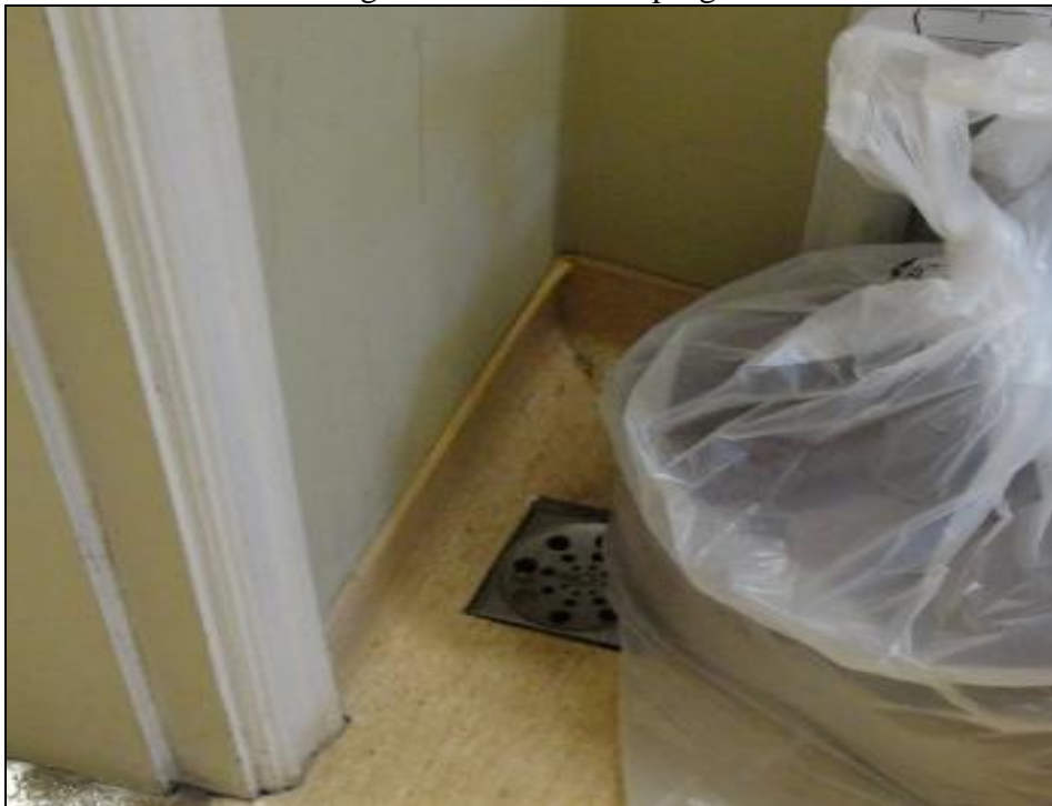
Figura 16 - Ralo do expurgo
