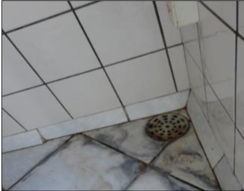
Figura 24 - Ralo para escoamento das sujidades
