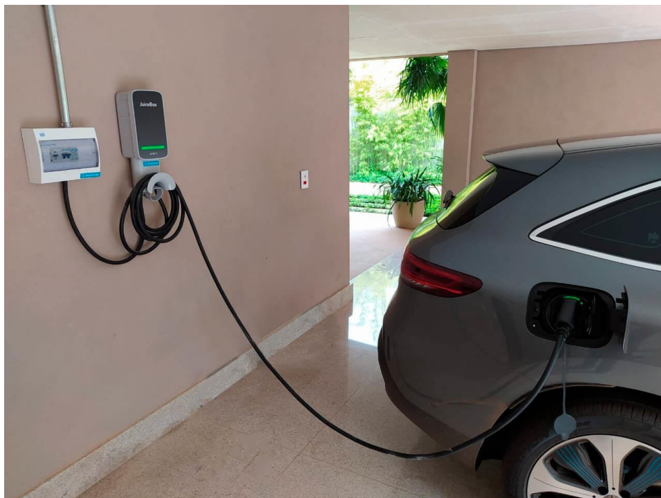
Figura 36: Realização de carga com wallbox
