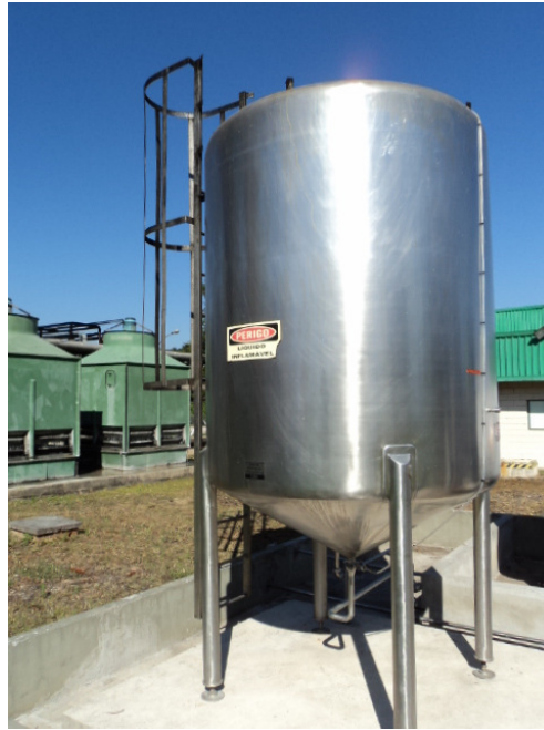
Figura 7 – Tanque de armazenagem 6.000 L Fonte: Grupo Centroflora, 2011
