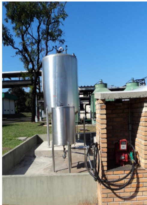
Figura 6 – Ponto de abastecimento
