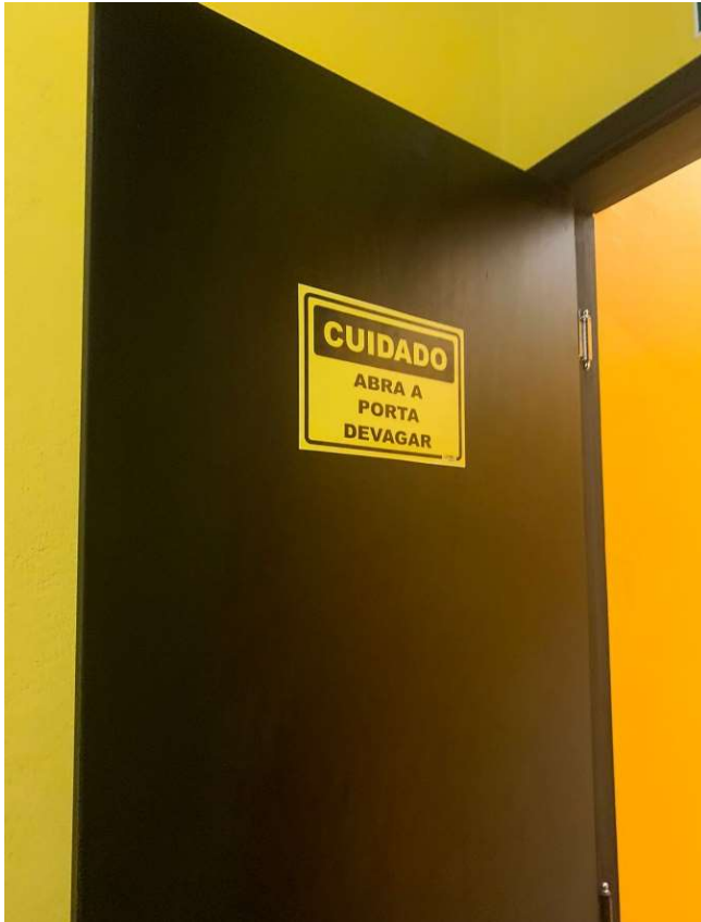
Aplicação de sinalização em porta bang-bang.
