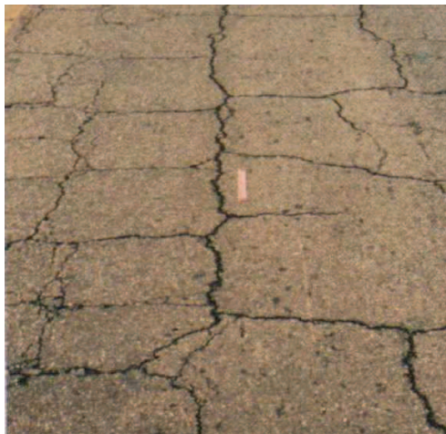
Figura 23 - Trincas em blocos: a foto revela o nível de severidade média. 18
