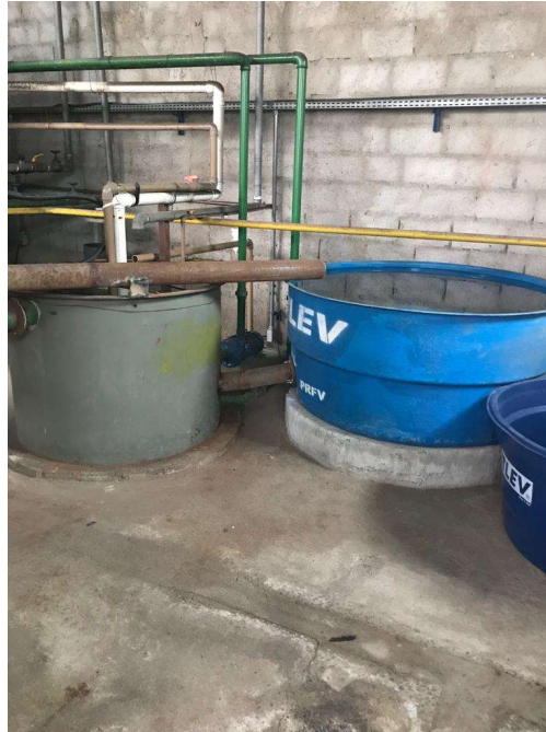
Figura 8- Tanque resfriamento do forno à vácuo
