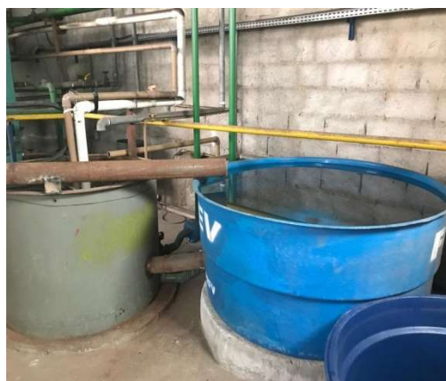
Figura 7-Tanque de resfriamento do forno à vácuo
