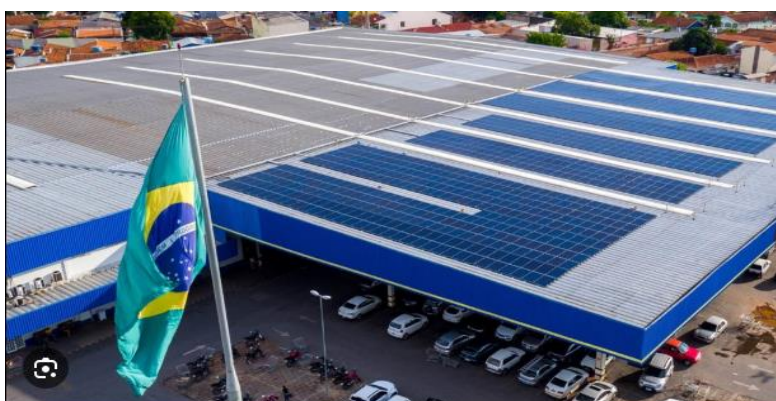
Figura 1: modelo de placas instalados no telhado de um comércio.
