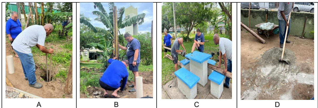
FIGURA 4 — Construção da estrutura do viveiro (A: abertura dos buracos para inserção dos pontaletes; B: medição do madeiramento; C: corte dos pontaletes no tamanho desejado; D: preparação do concreto) (fonte: do autor, 2023).
