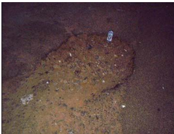
Figura 2. Buraco causado após chuvas na cidade de Botucatu
