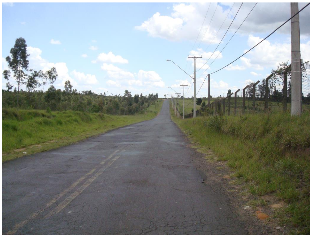
Figura 16. Falta de cuidados com a via, sem calçamento para pedestres e coleta de águas pluviais, que geram transtorno aos usuários do sistema viário.
