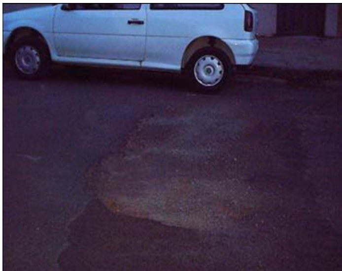
Figura 1. Defeito em reparo de vala na cidade de Botucatu
