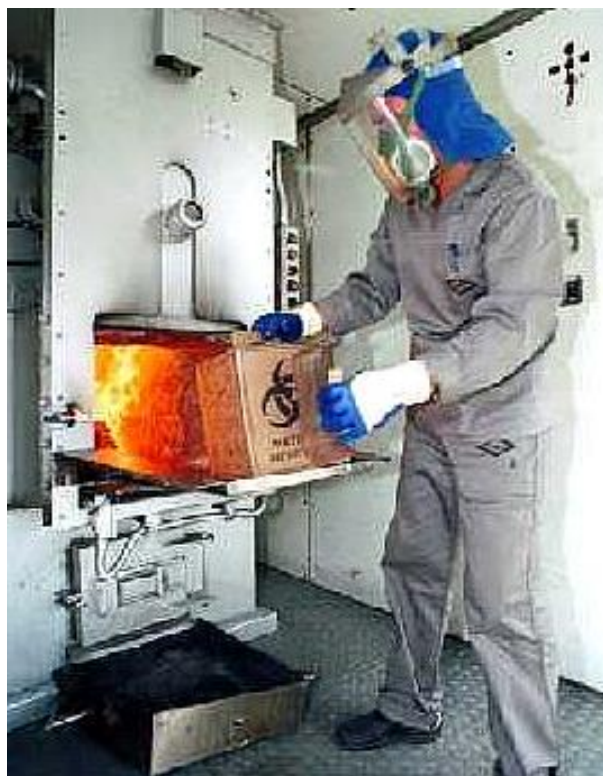
Figura 16. Incinerador de resíduos sólidos de serviço de saúde.
