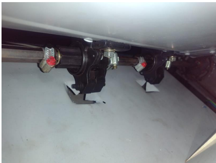
Figura 6 : Rotor FONTE: Próprios autores
