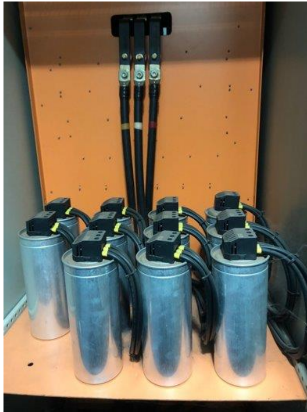
Figura 9. Banco de capacitores
