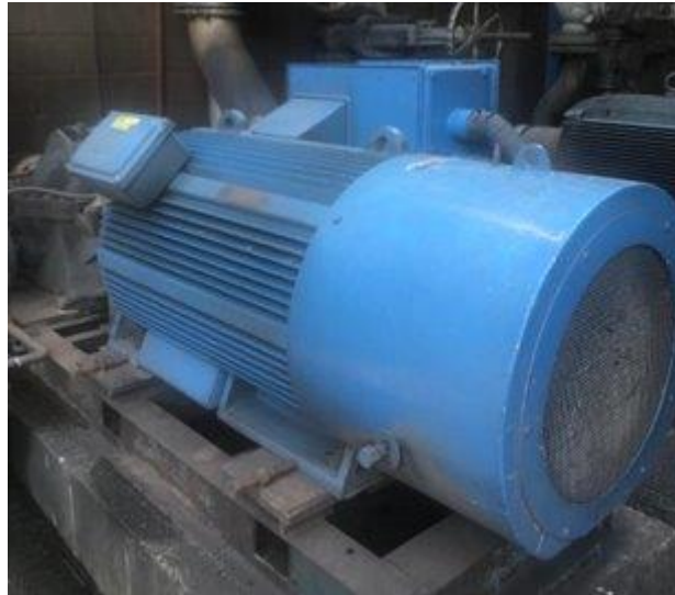
Figura 4. Motor trifasico operando com subcarga
