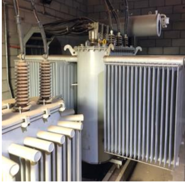
Figura 3. Imagem de alguns transformadores
