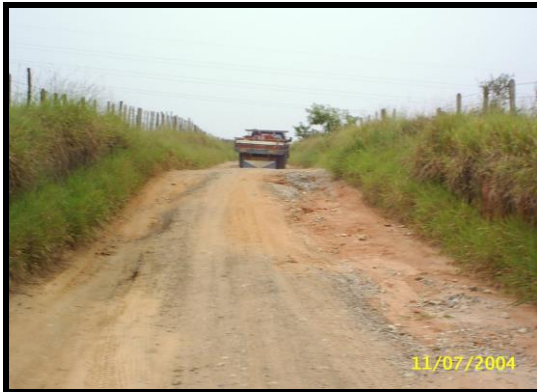
Figura 2– Buracos Estrada de terra partindo do Km 209 da Rod. Mal. Rondon. Foto produzida pelo autor (2005)
