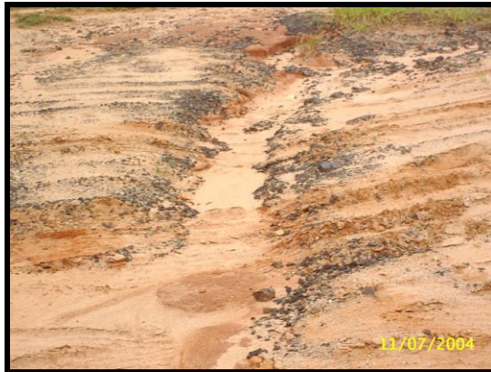
Figura 5– Curva de nível avariada Estrada de terra partindo do Km 206 da Rod. Mal. Rondon. Foto produzida pelo autor (2005)
