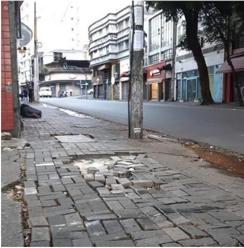
Imagem 3: blocos de concreto em estado de ruínas
