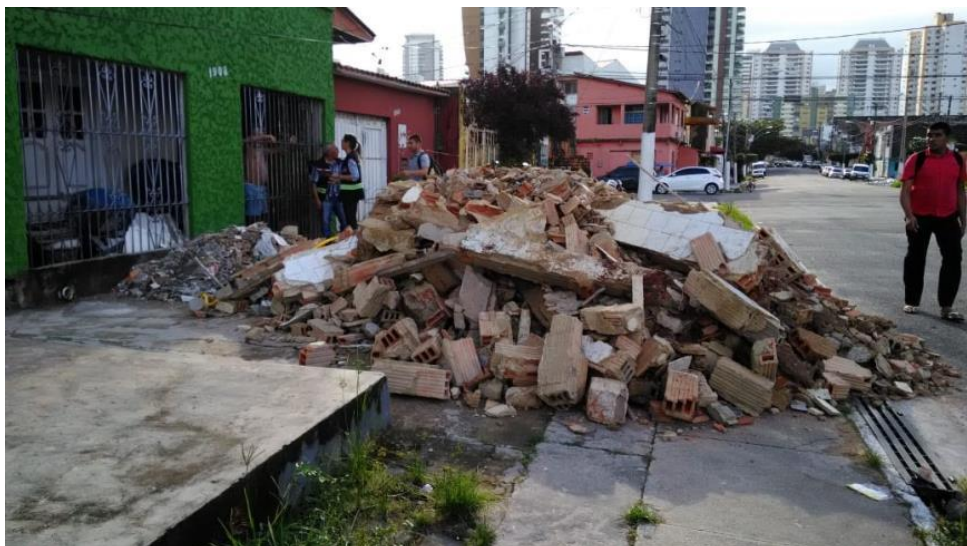
Figura 02 - Resíduos da construção civil em via pública
