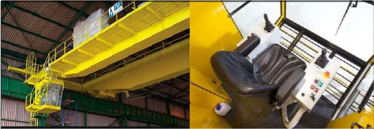
Figura 1.20 - Cabine de operação
