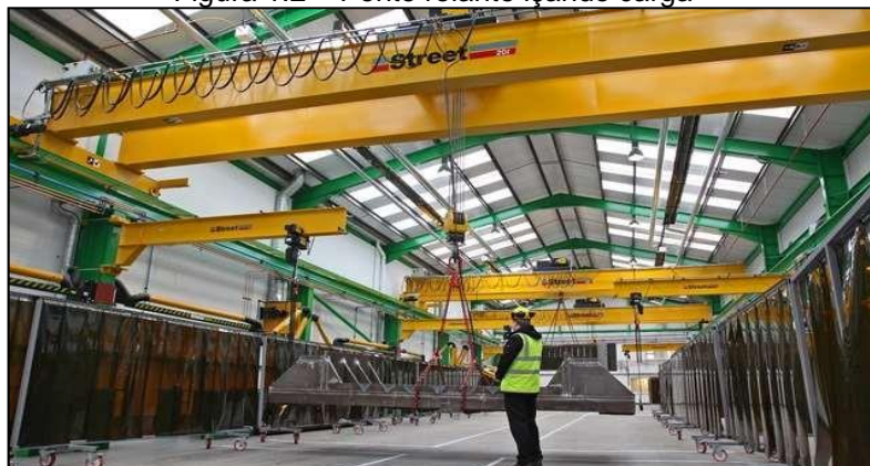
Figura 1.2 – Ponte rolante içando carga
