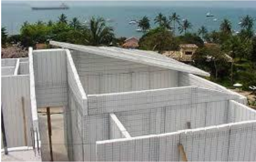
Foto 02 – EPS sem reboco
