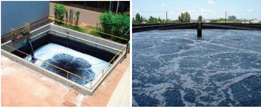
Figura 29 – sistema de aeração.
