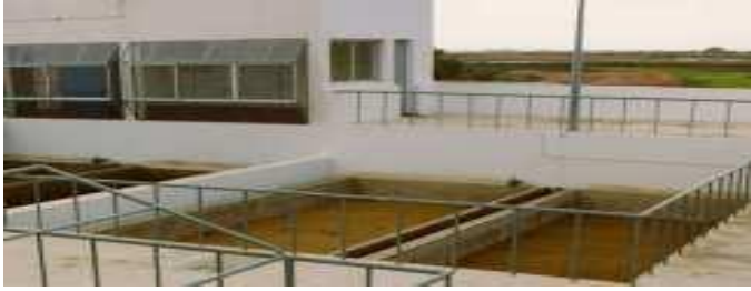
Figura 25 – caixas de areia.
