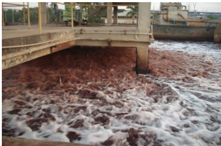
Figura 33: Tanque onde ocorre a floculação.
