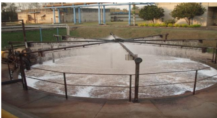
Figura 34: Chuveiro de resfriamento de água.
