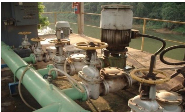
Figura 31: Bombas de captação de água.
