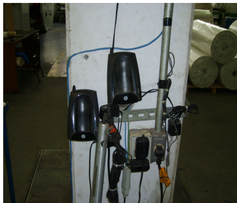
Figura 4 - Fios de eletricidade à mostra e não rotulados
